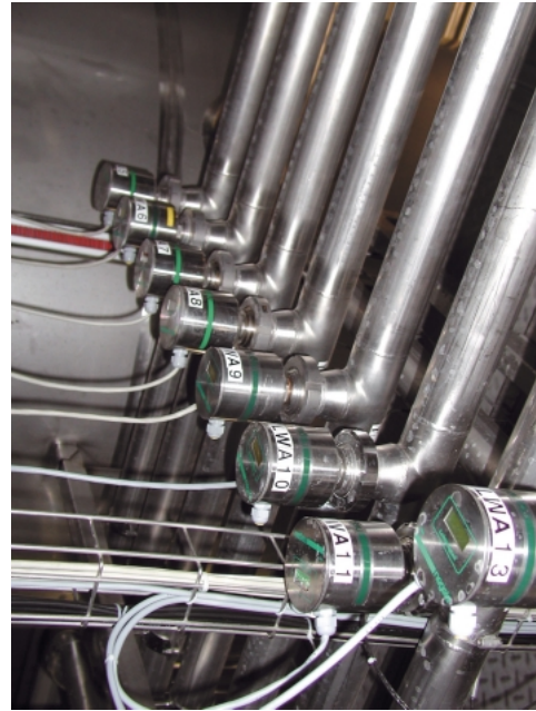
ilm-2 montati su un circuito CIP-di lavaggio in fase di separazione di soda-acido-acqua.
